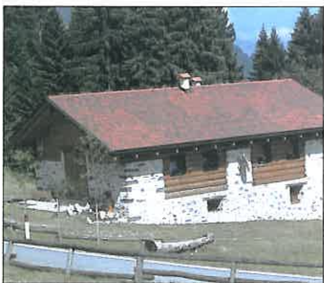
Tetto rifatto con modifica caratteristiche originarie; manto in tegole ad impasto ceramico.
